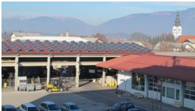
Slika 57: Sončna elektrarna MFE Primskovo na strehi skladišča EG
