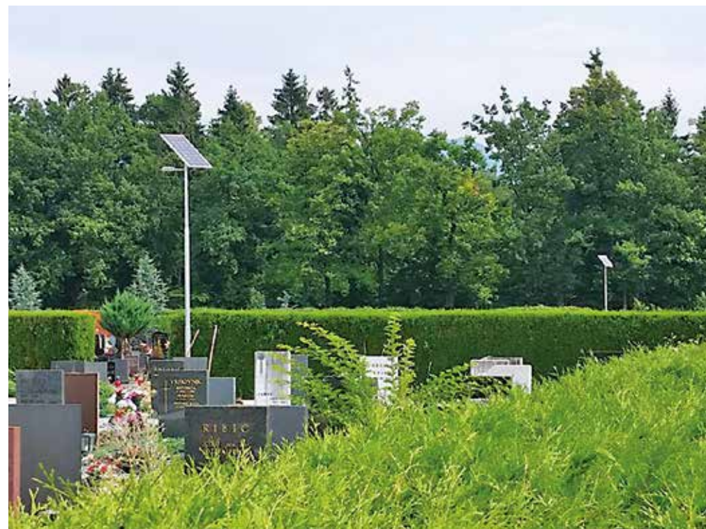
Na mestnem pokopališču so montirane solarne luči za razsvetljavo poti ponoči.
