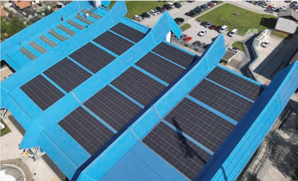
Sončna elektrarna na strehi olimpijskega bazena v Kranju / Foto: MOK
