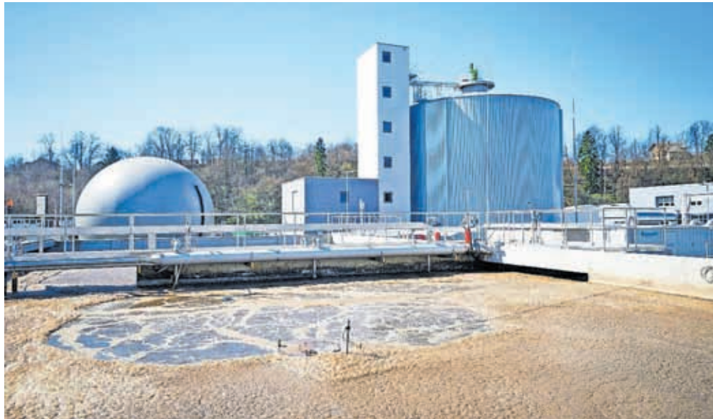
Biološki bazen, plinohram in gnilišče na Centralni čistilni napravi Kranj / FOTO: SAMO PAUŠER
